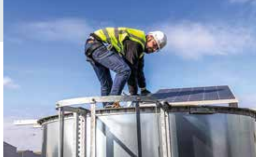
Le bureau d'études de VERGNET HYDRO (Service Ingénierie d'Affaires) dispose de moyens d'essais permettant d'optimiser ses dimensionnements et installations solaires.
