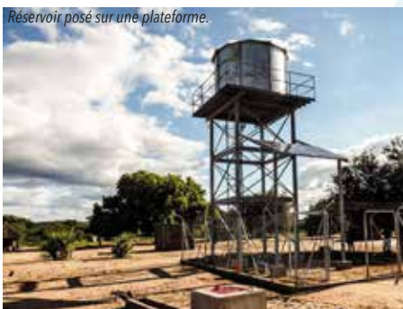
Réservoir posé sur une plateforme.
