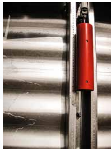
Indicateur de niveau, sur la paroi extérieure du réservoir.
